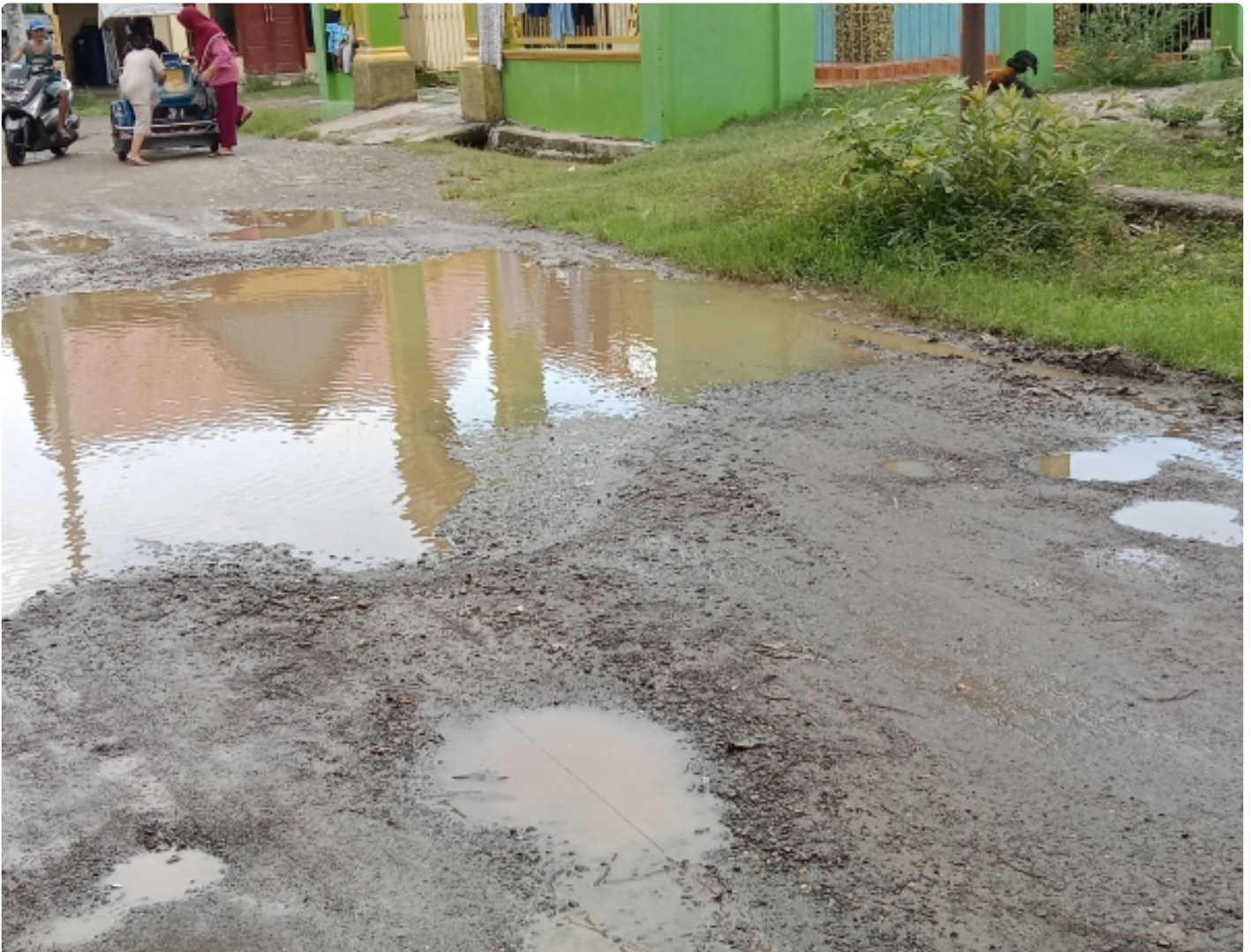
Jalan poros perumahan Citramas/Pallateang Kelurahan Biraeng rusak berat
