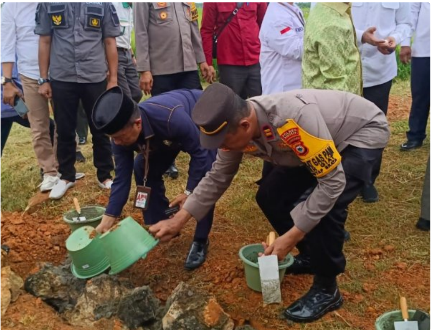
Kapolsek Minasatene Pimpin Langsung PAM Peletakan Batu Pertama Pembangunan Baznas Institute Bontolangkasa
