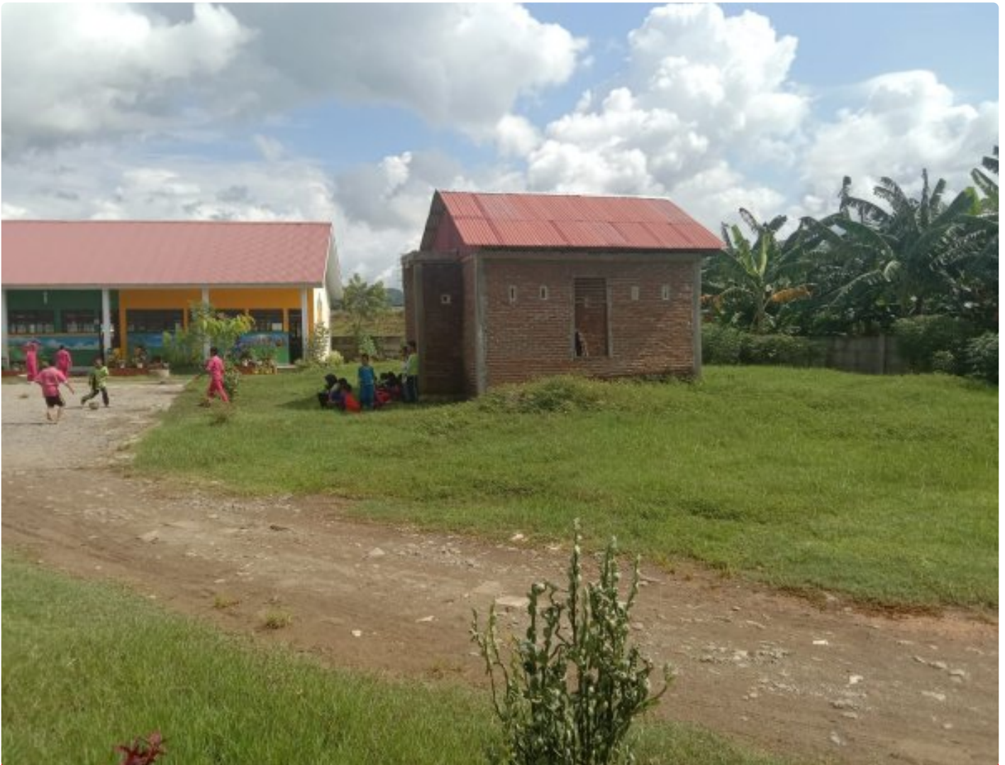
Butuh Perhatian, Bangunan Mushola di SDN 22 Soreang Pangkep Tak Kunjung Selesai
